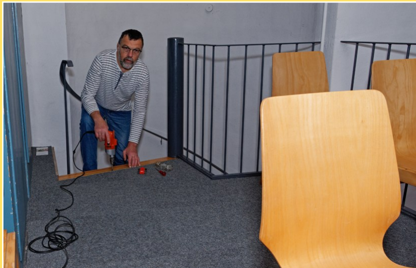
Letzte Handgriffe und Abschluss einer Sanierungsmaßnahme. Herzlichen Dank an Jürgen Vollgraff für das Verlegen der Bodenfliesen auf der Empore in der Kirche Fürstenhagen.
